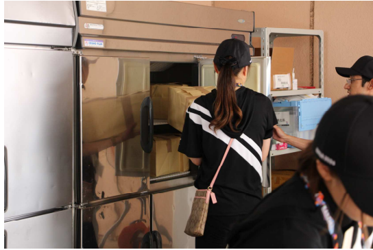
弁当保管冷蔵庫
